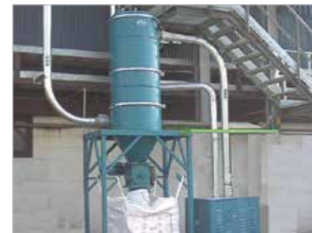
中央气泵 Central air pump
